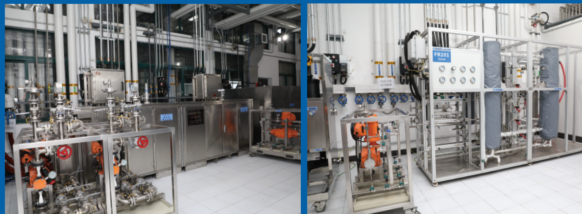
药石科技浙江晖石生产基地连续化生产GMP车间
